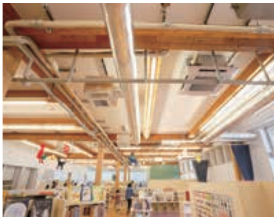
仕上げをせず、排管むき出しの天井は予算削減のため。しかし、これに対するクレームは一つもないとのこと
